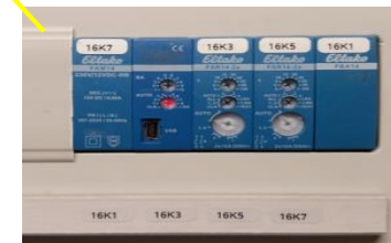
Relais für PV-Optimierung (WP+Boiler+Haushaltgeräte)
